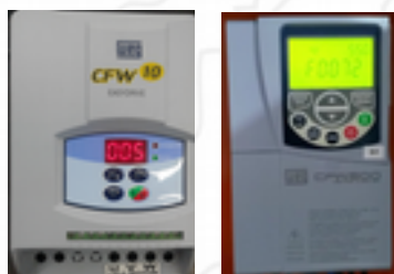
Fig. 01: Inversor CFW10 apresentando erro E05 e inversor CFW500 apresentando erro F0072.
