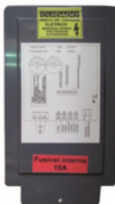
Fig. 04: Inversor com a placa embutida
